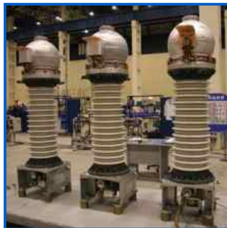
Элегазовые трансформаторы тока ТРГ-110
